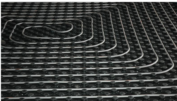
Riscaldamento a pavimento
